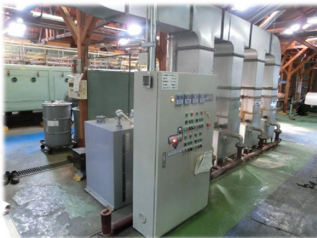
・ 11号機系統の処理機
