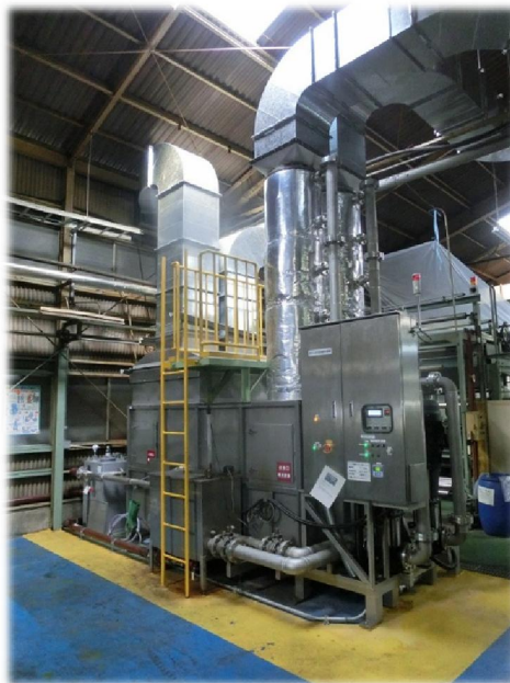
・ 1号機系統の処理機
