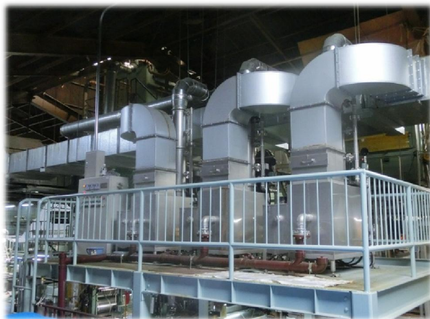
・ 2号機系統の処理機
