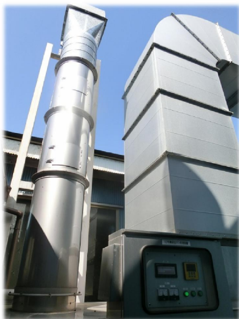
・ 10号機系統の処理機
